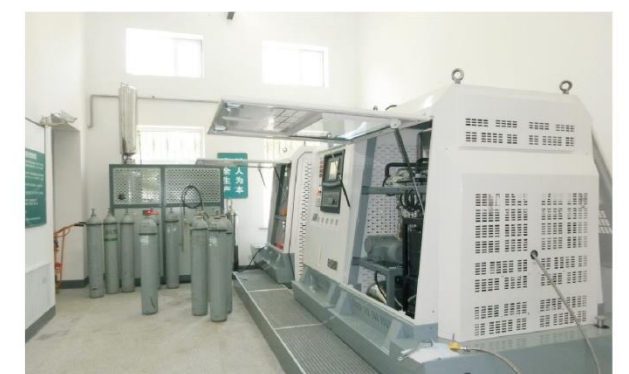
База очистки газа Хэйлунцзянской электроэнергетической компании SF 6
