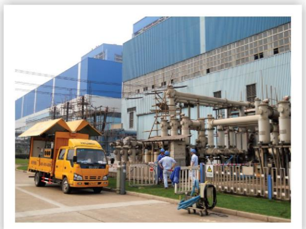
Подстанция 500 кВ газовой электростанции
