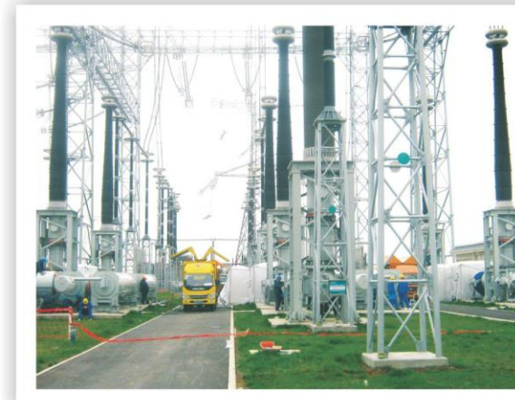
Подстанция сверхвысокого напряжения 1000 кВ
