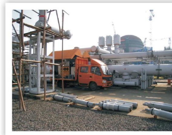
Подстанция 500 кВ на атомной электростанции
